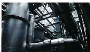
プラント配管
