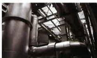
プラント配管
